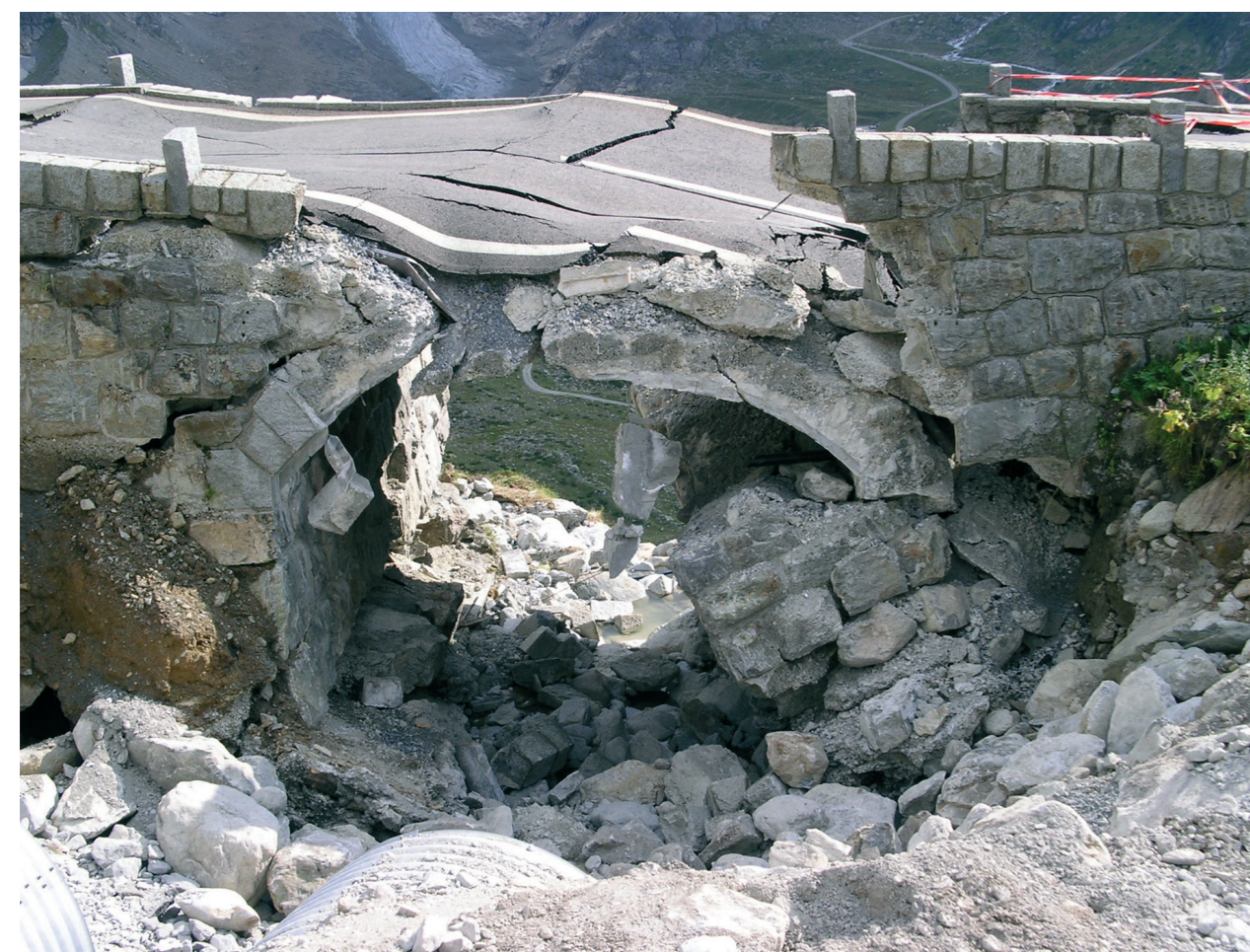
Abb. 3: Zerstörte Brücke nach einem Starkregen in den Alpen. Foto: Bareis
